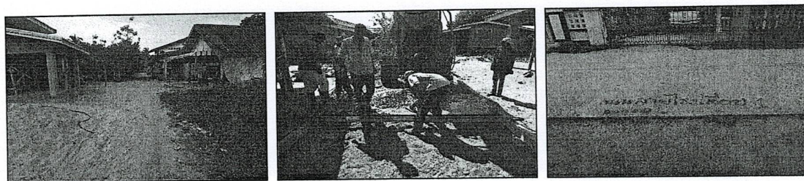
9. โครงการก่อสร้างถนน คสล.สายโรงเลื่อย 1 ชุมชนตาบาตะโปเมาะ
